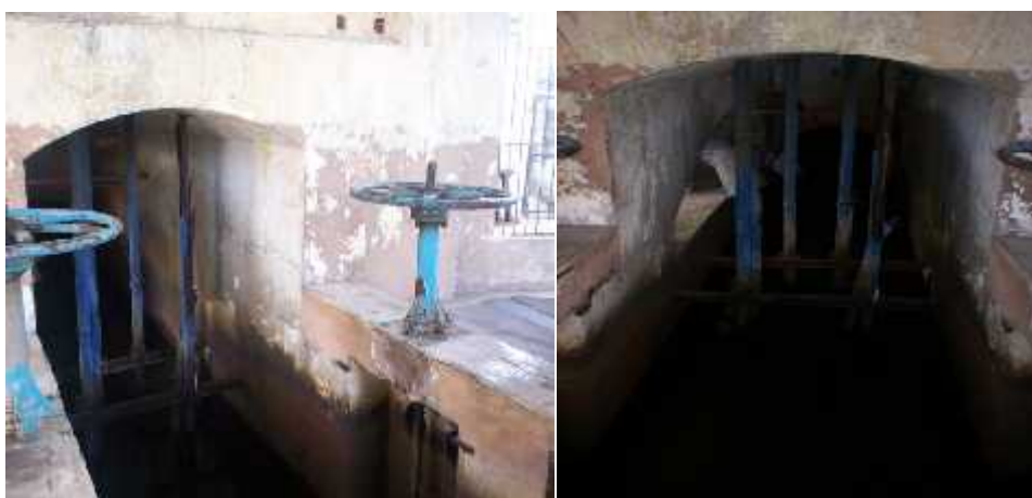
Anexo No. 27 Compuertas de Salida del Tunel
