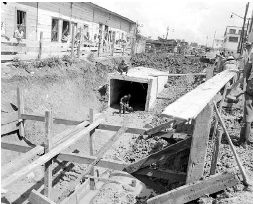
Anexo No. 18 Canalización de una de las derivaciones de la Zanja Real en la Calzada del Cerro. Año 1952
